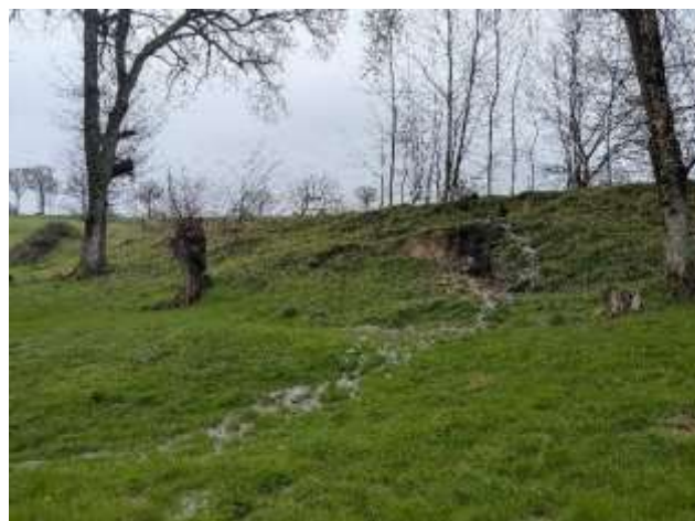
Chaussée déstructurée par les ragondins
